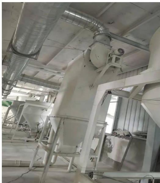
码垛除尘设备
