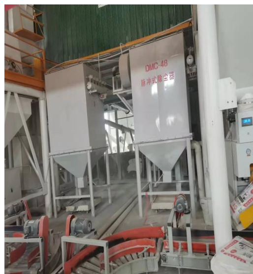
混合搅拌除尘设备
