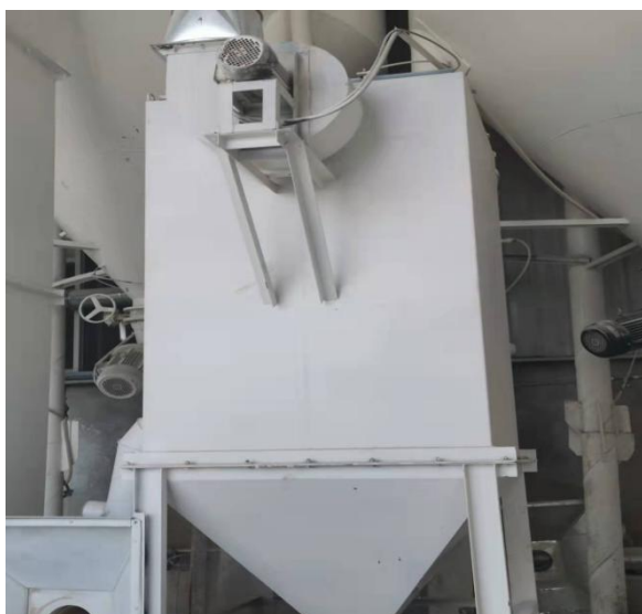
投料除尘设备
